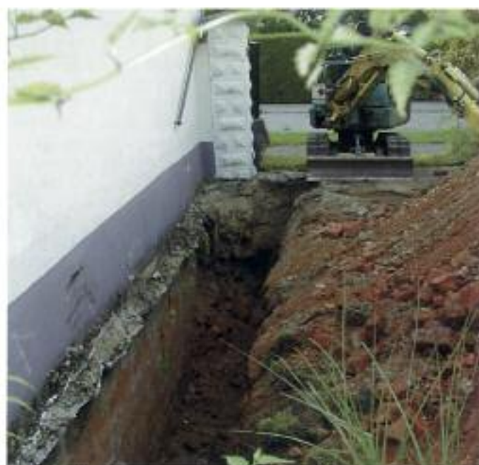
Eine fehlende Außenisolierung kann nur durch Aufgraben nachträglich angebracht werden, ist bei fachmännisch ausgeführter Innenisolierung aber nicht unbedingt notwendig
